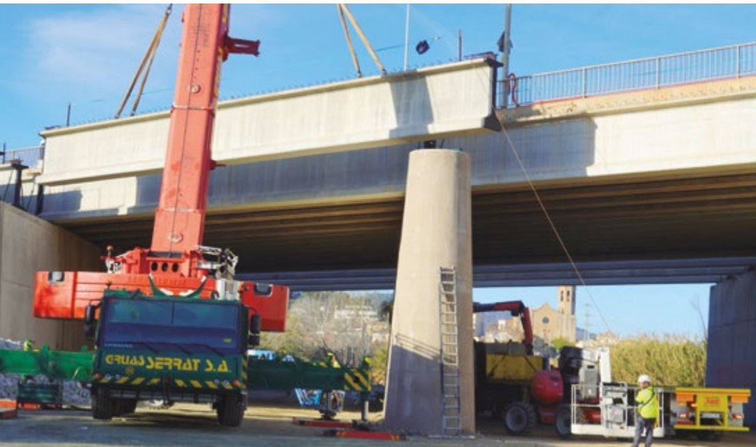
Una gran grúa colocó las vigas para ampliar la calzada a la altura del puente
