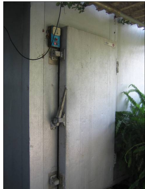
Detall de l'estructura de cambra frigorífica.
